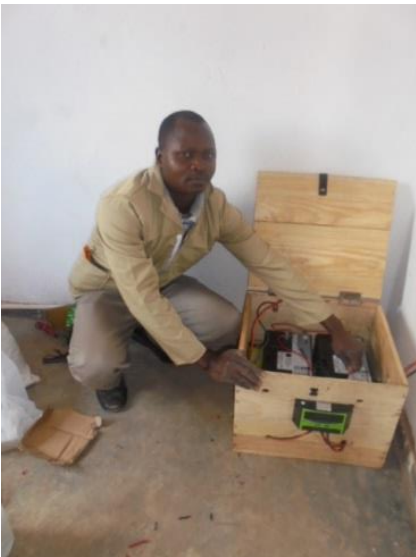
De accu's van de zonnepanelen
